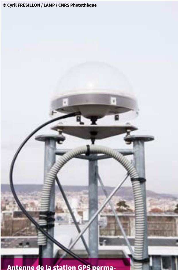
Antenne de la station GPS permanente installée sur le toit du Laboratoire de météorologie physique (LaMP), rattachée au réseau RENAG (Réseau national GPS permanent)
